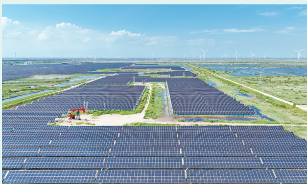
胜利油田积极发展新能源产业,油田生产绿电占比达到26%。图为孤东106兆瓦集中式光伏项目。
