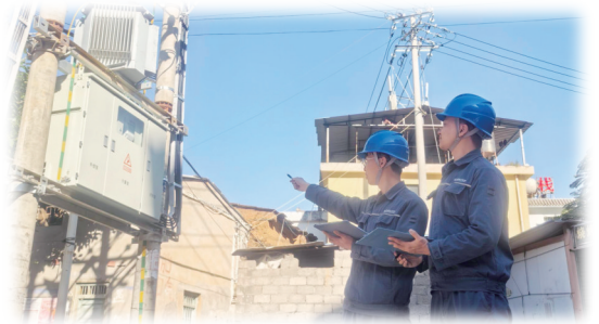
图为南方电网云南昆明东川供电局工作人员检查设备情况。 索明/摄
