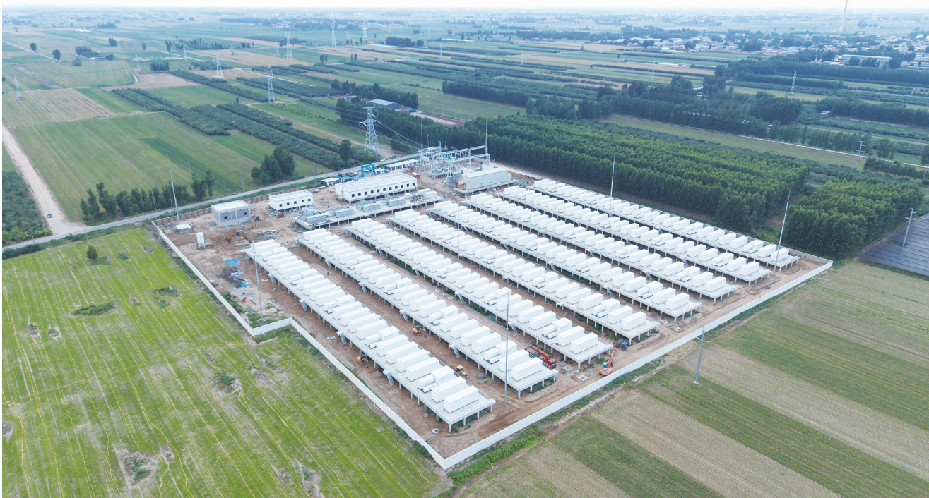
图为合肥西花岗200MW/400MWh储能电站。
