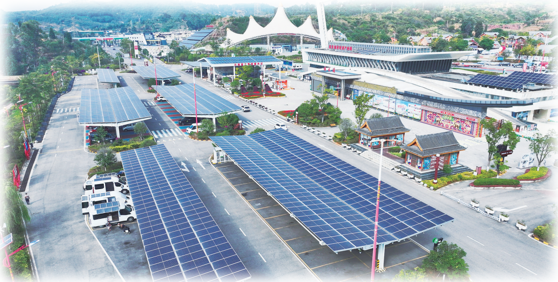
服务区充分利用边坡、车棚、屋顶等闲置资源,建成分布式光伏发电系统,服务区用电量中光伏绿电占比约72%。 卢显仑/摄
