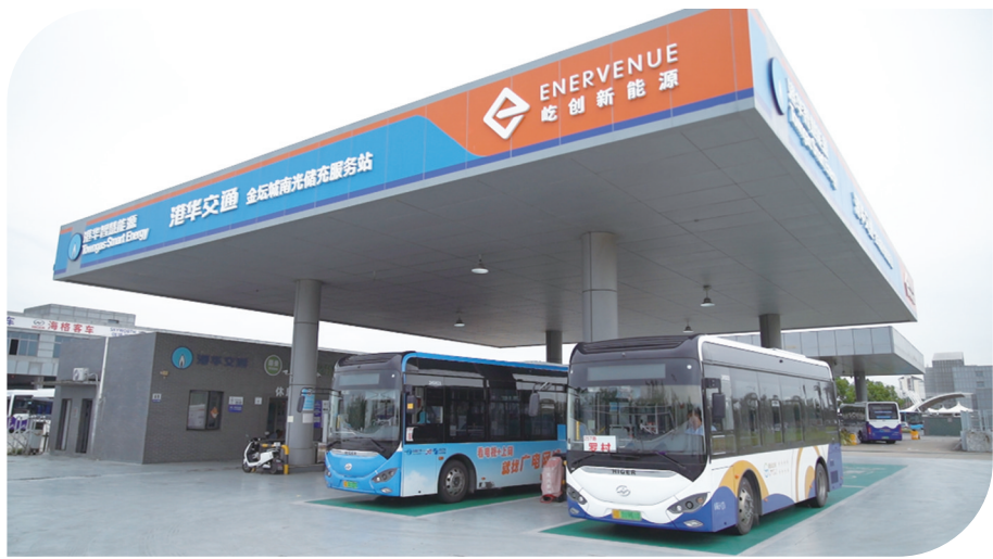
常州金坛光储充一体化示范电站。屹创新能源/供图
