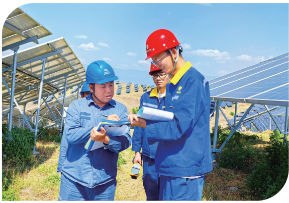
在弥渡区域光伏电站,供电员工与运维人员共同开展设备巡检。李丽娟/摄
