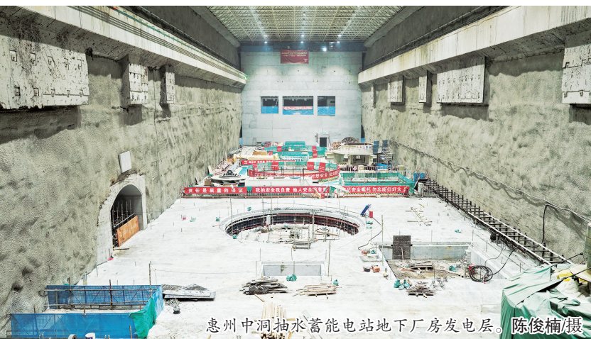
惠州中洞抽水蓄能电站地下厂房发电层。陈俊楠/摄
