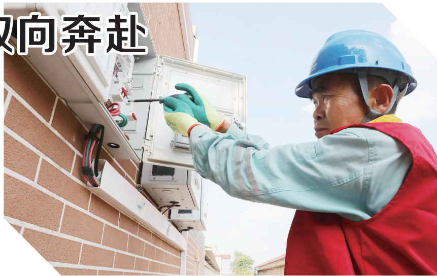
临汾供电公司僧念供电所员工在段村排查线路隐患。陈爱红/摄
