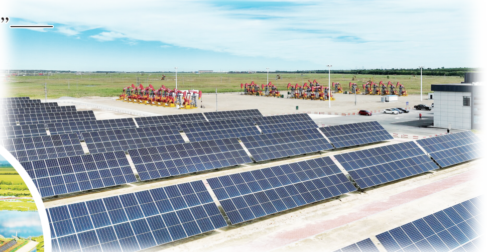
图为吉林油田新立“零碳工厂”生产现场。
