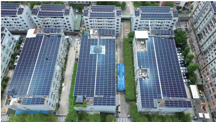
图为宝安区新桥街道横岗下工业园区“四可”光伏示范项目。黄志伟/摄
