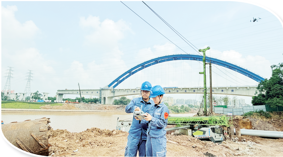
南方电网广西钦州供电局平陆运河用电保障青年突击队对青年枢纽供电线路110千伏牛头湾站10千伏青牛线开展线路巡视。 陆小娥/摄
