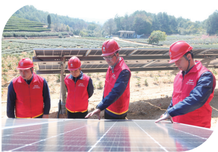
国家电网福建电力(武夷大红袍)“双满意”共产党员服务队检查茶园智微网光伏板发电情况。 陈龙辉/摄
