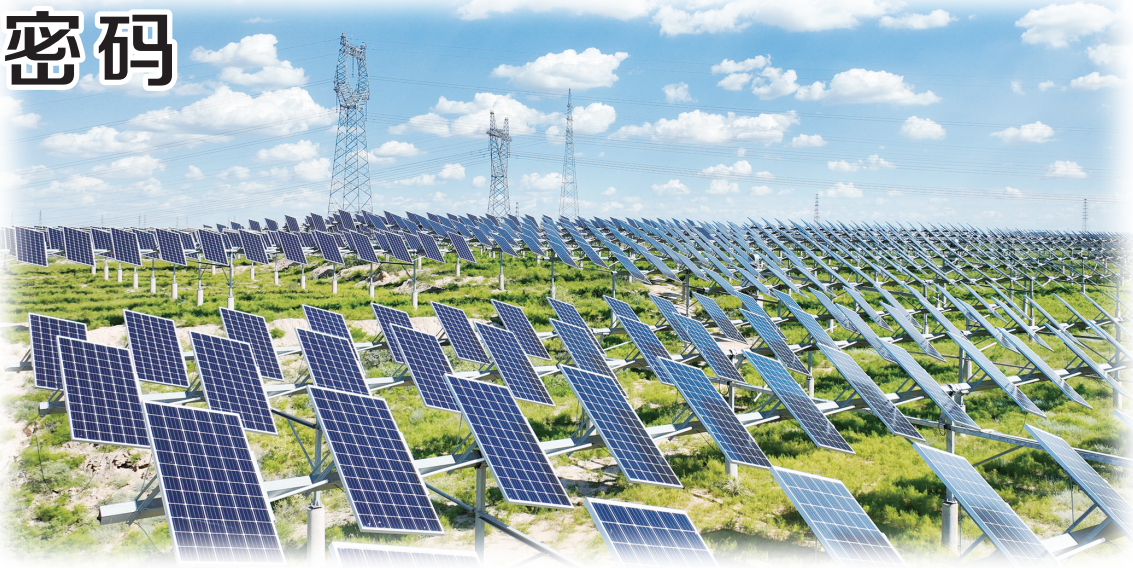
宁夏回族自治区银川市兴庆区的银川第四光伏电站,通过月牙湖330千伏变电站源源不断地将绿色电能输送至千家万户。
