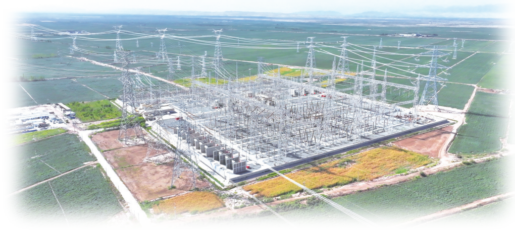
图为南疆喀什2×66万千瓦煤电750千伏送出工程。阿卜杜热扎克·吐尔逊艾力/摄
