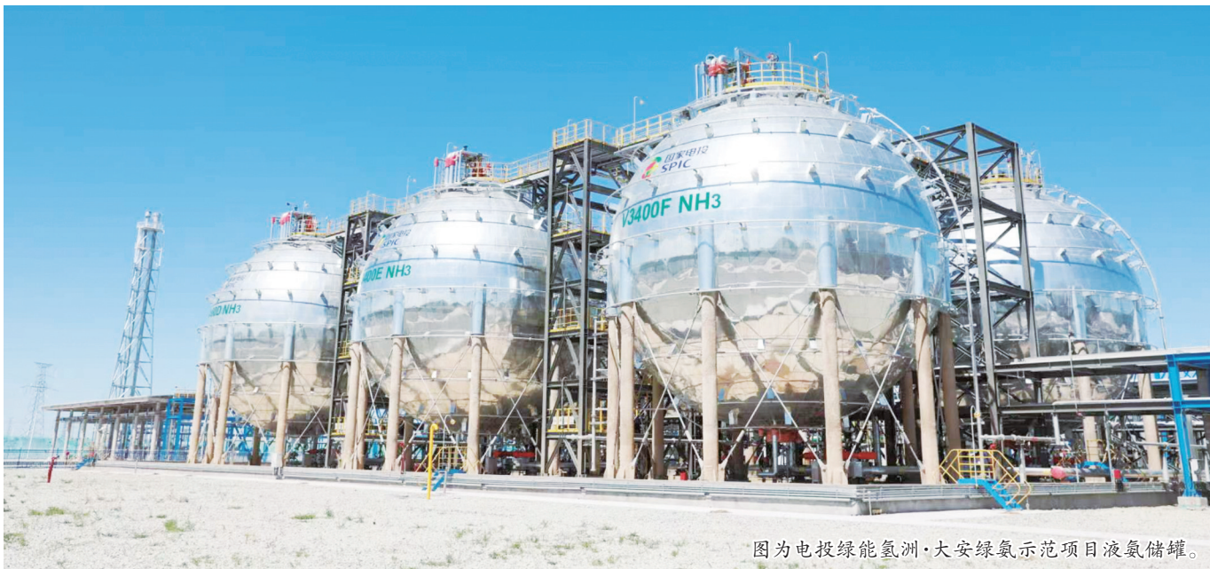
图为电投绿能氢洲·大安绿氢示范项目液氨储罐。
