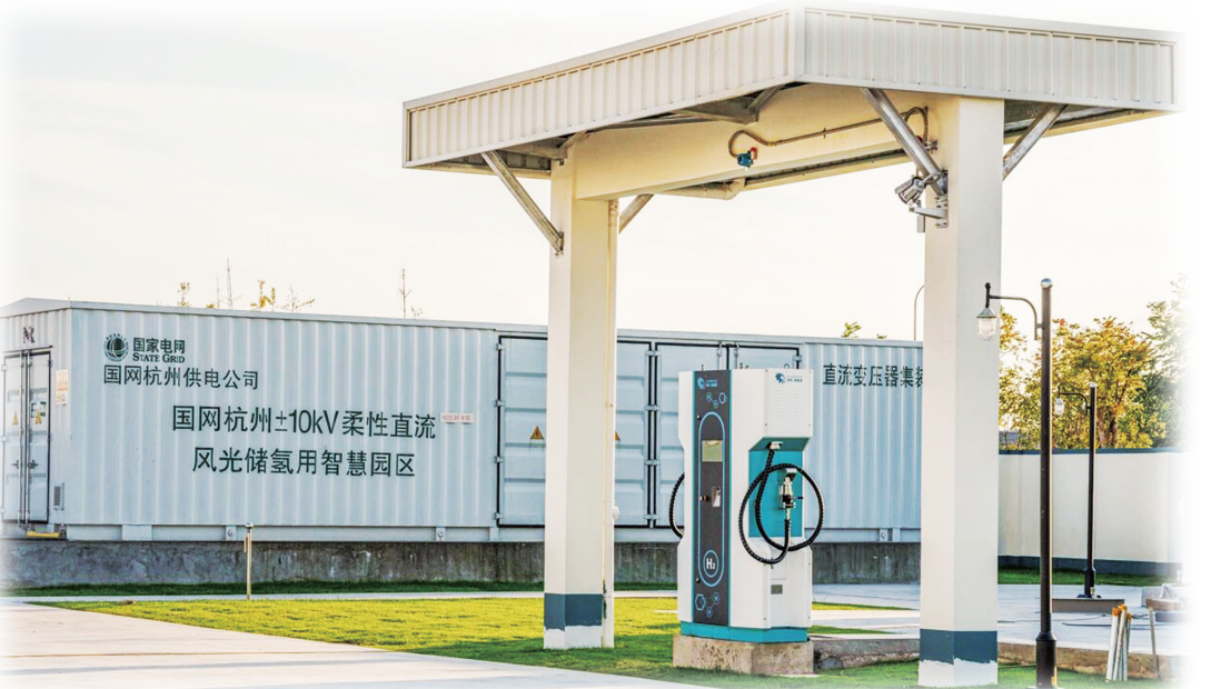
图为全国首个柔性直流氢电耦合“零碳”园区让钱塘江畔的风光变成“氢”和“电”。丁豪/摄
