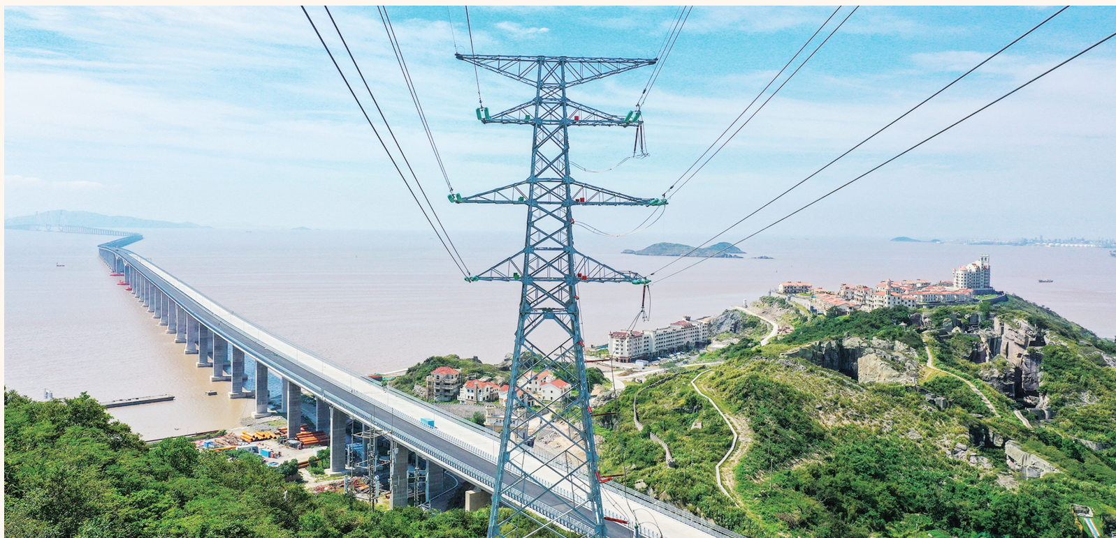
洛迦—鱼东 220 千伏输电线路。 姚峰/摄
