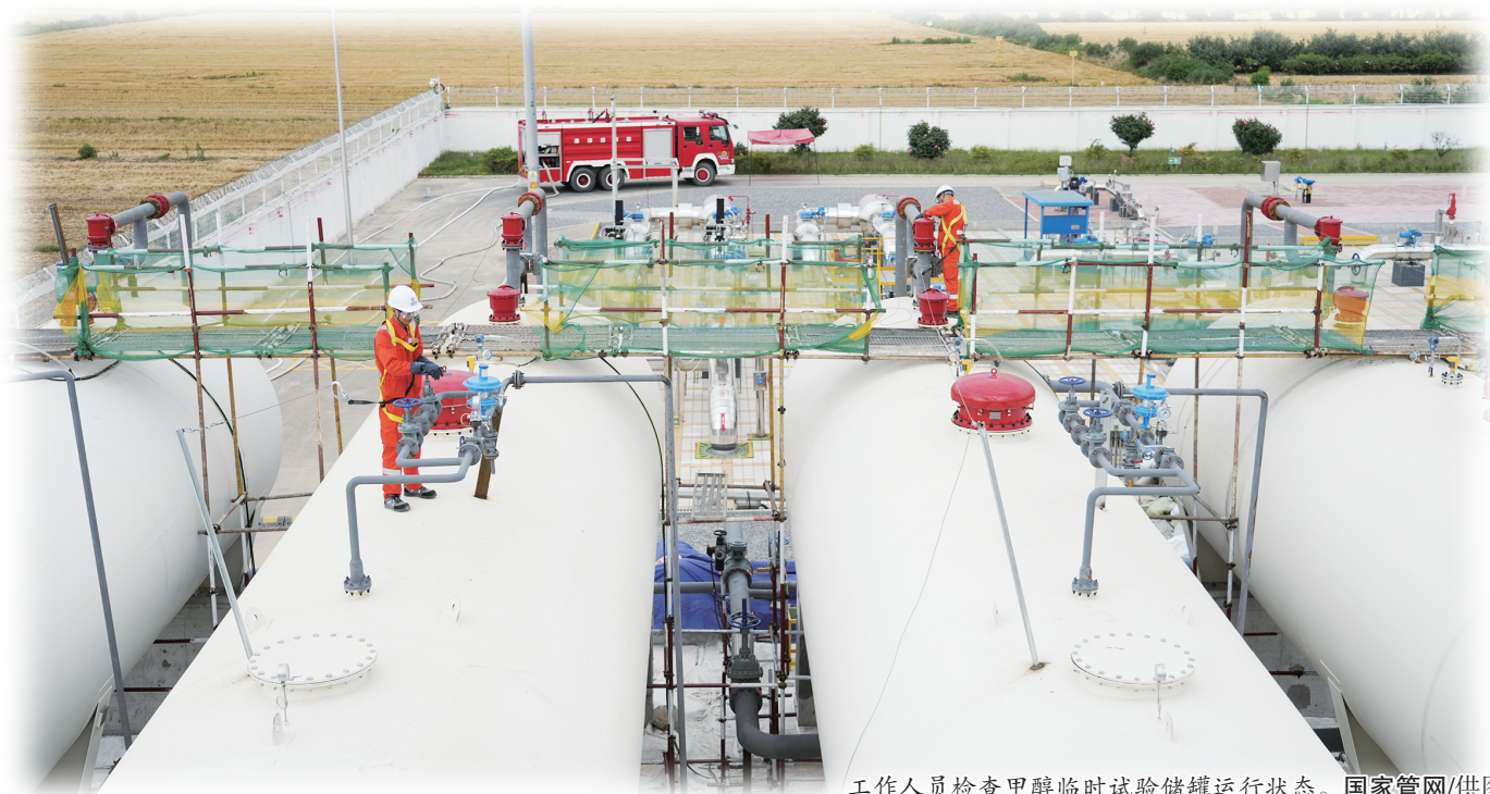
工作人员检查甲醇临时试验储罐运行状态。国家电网/供图
