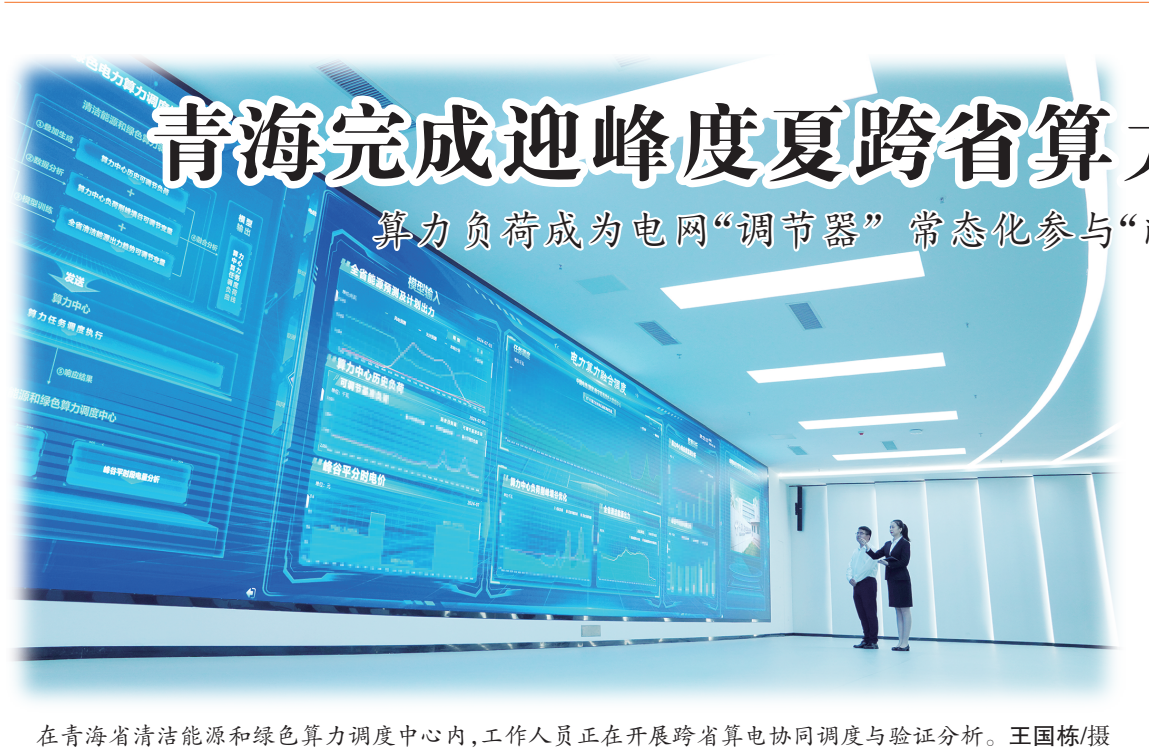
在青海省清洁能源和绿色算力调度中心内, 工作人员正在开展跨省算电协同调度与验证分析。 王国栋/摄
