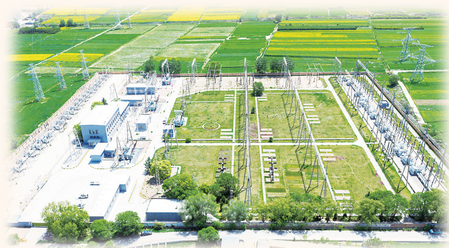
航拍花园330千伏变电站。范正辉/摄
