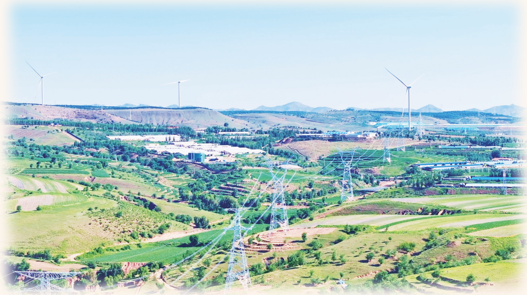
蒙东赤峰紫城——东山500千伏线路工程——500千伏紫连线。曹旭/摄
