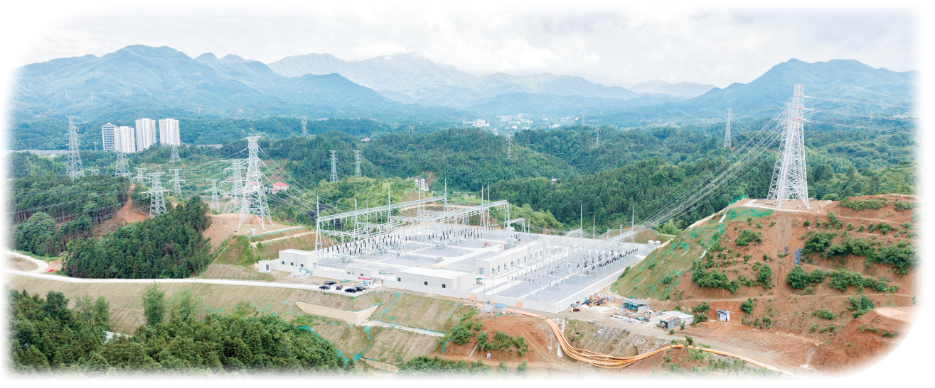
宜春220千伏花博园变电站全貌。
