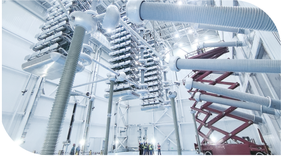
青藏直流工程开展二期扩建后首次年度检修,工作人员在±400千伏柴达木换流站开展换流阀检查维护。董庆芳/摄
