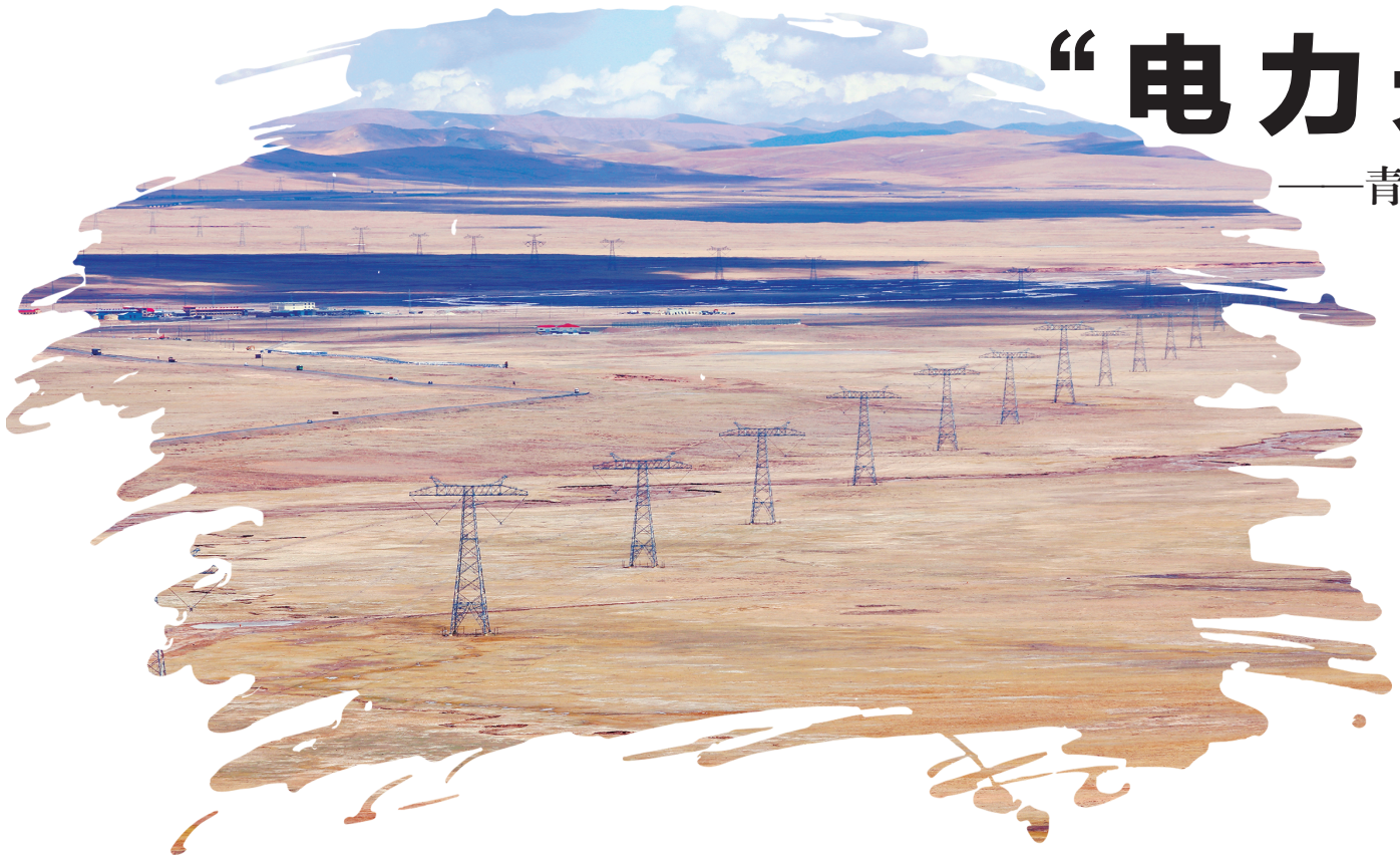
青藏直流工程架起连接西藏的能源大动脉,枯水期“送电进藏”,丰水期“藏电外送”。谢莉蓉/摄
