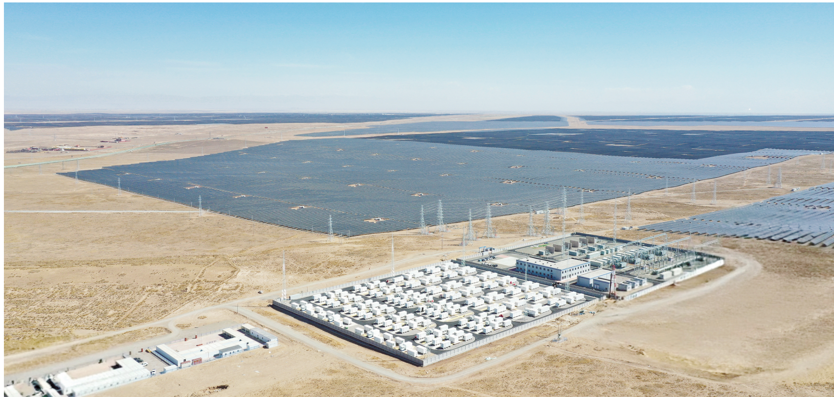
图为位于青海省海南州的黄河伏山共和 200 兆瓦/800 兆瓦时储能项目。 韩文彬/摄
