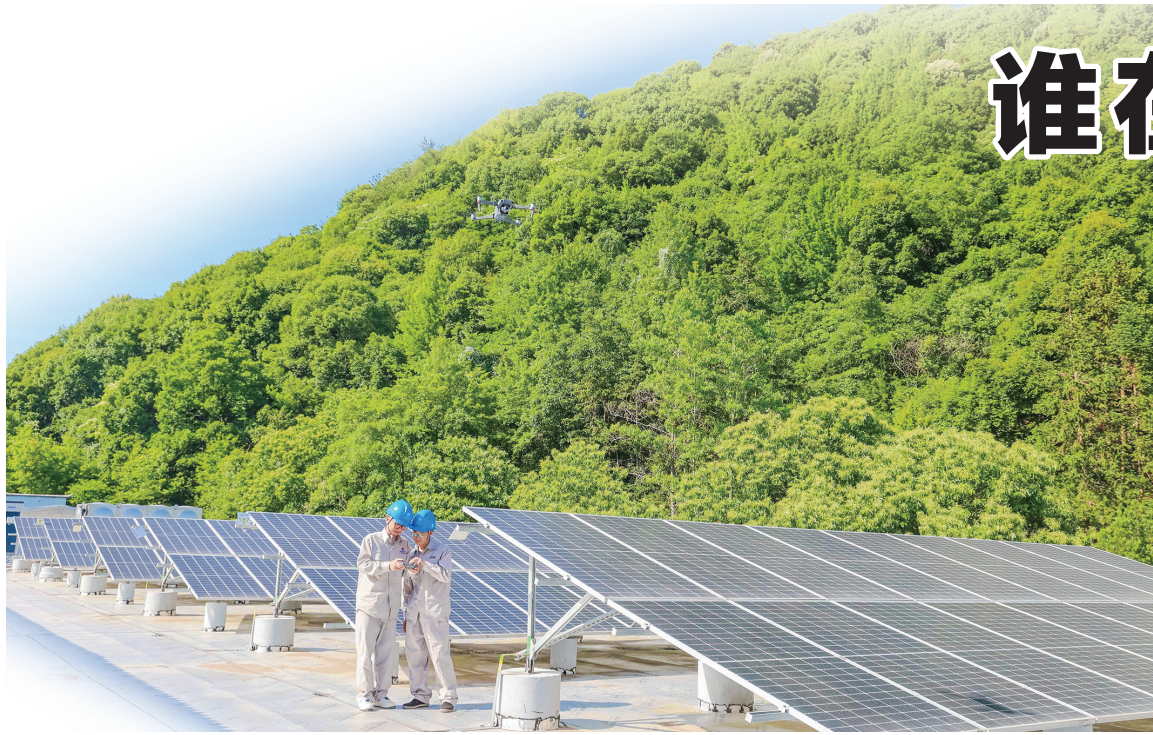
图为国网缙云县供电公司员工到新碧工业园区屋顶对企业光伏开展巡视。楼拓斌/摄
