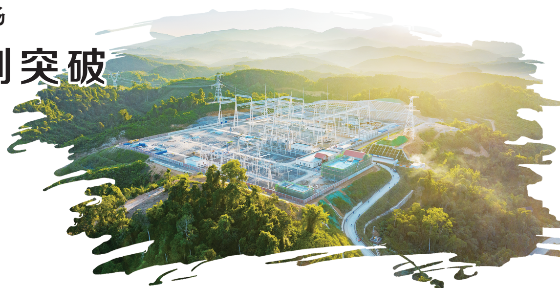
图为位于老挝乌多姆塞省的500千伏那磨变电站。南方电网公司/供图
