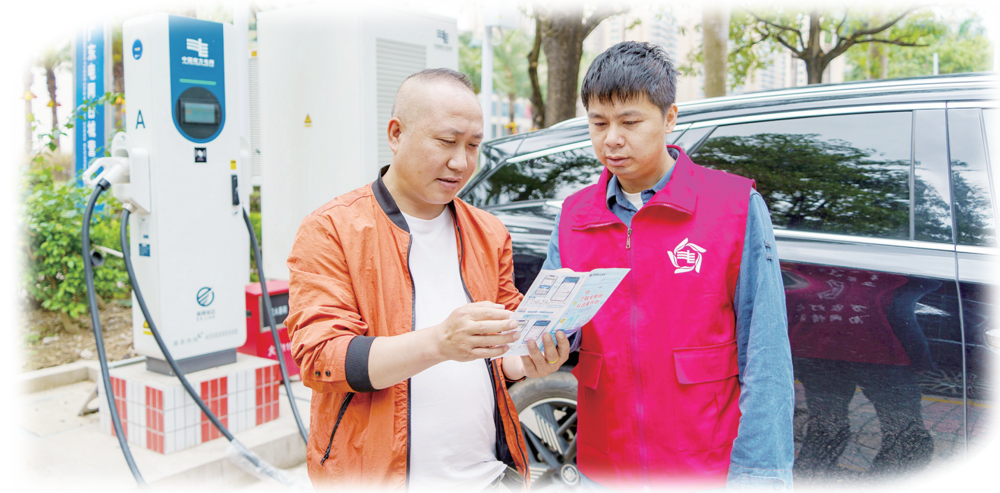
南方电网广东江门台山供电局台城供电所工作人员对超级充电桩开展全面巡检维护，并协助返乡侨胞充电。郑茵茵/摄
