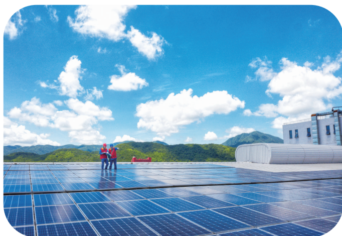
国网象山县供电公司工作人员来到东陈乡城南开发区，对企业光伏开展专项检查，助力企业绿色可持续发展。王启翔/摄
