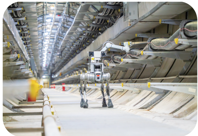
国网宁波供电公司“巡检卫士”四足机器人在潘桥电缆隧道内开展自主巡视。林馨/摄
