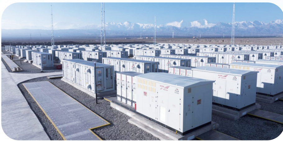
图为新疆克州300MW/1200MWh构网型独立储能项目。科华数能/供图
