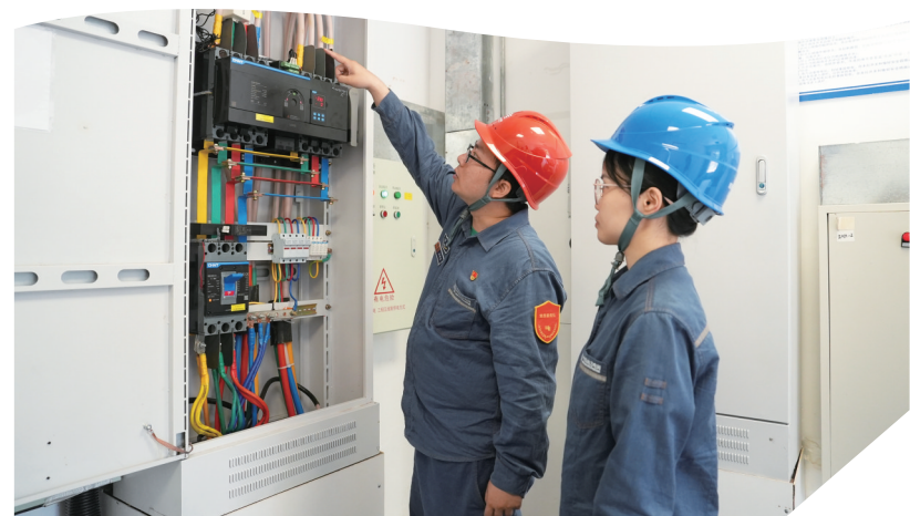
海南电网博鳌保电工作人员在博鳌东屿岛一配电房检查小微智能传感器运行情况。王涵璐/摄
