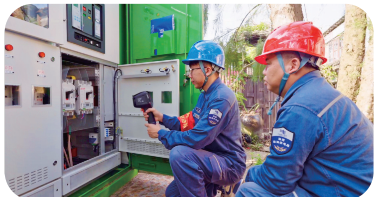
海南电网琼海供电局工作人员在“海的故事”街区进行供电设备检查。王涵璐/摄
