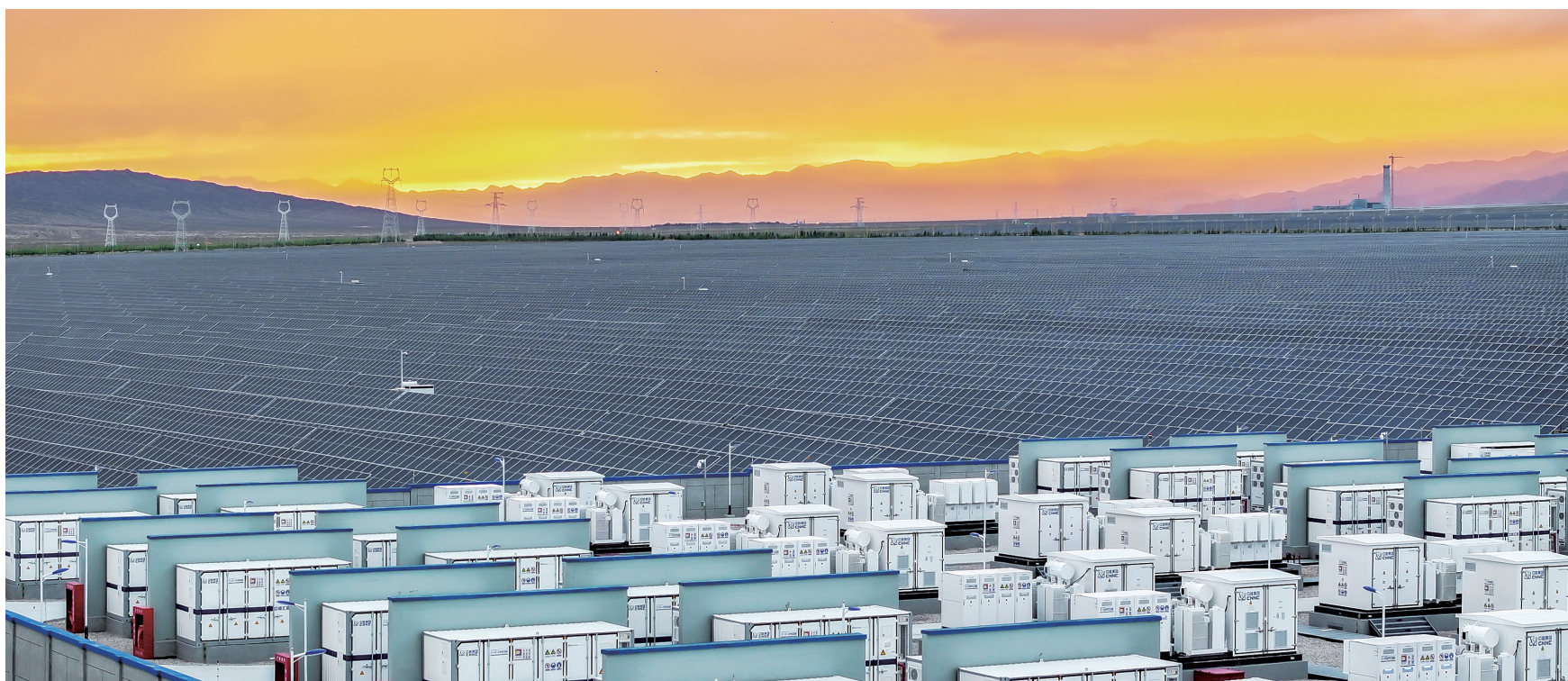
图为青海克鲁克75MW/300MWh电网侧电化学共享储能电站项目持续保障电力系统安全稳定运行。 天合光能/供图
