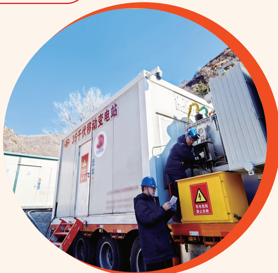
▲图为国网北京电力检修分公司变电施工人员春节前对35千伏掌上移动式变电站设备进行调试。 康晓岳/摄
