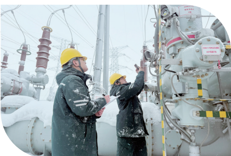
图为国网塔城供电公司员工在220千伏陶家变电站开展特巡。李欢/摄
