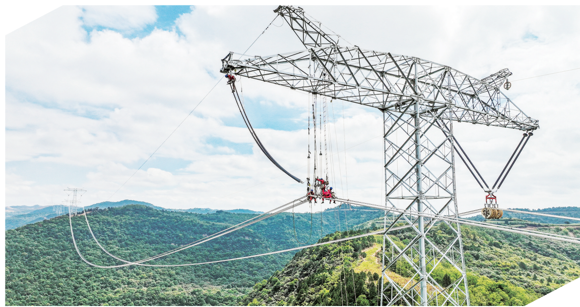
图为2024年10月1日,国网山西送变电公司高空作业人员在山西省临汾市古县陇东—山东±800千伏特高压直流输电线路工程(晋2标)施工现场进行附件安装作业。王浩/摄
