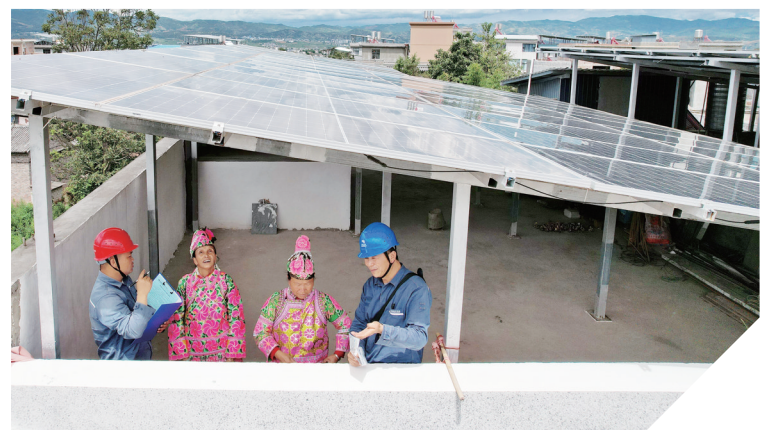
供电服务人员主动上门为村镇屋顶光伏用户讲解光伏板、逆变器的安全使用规范，消除用户后顾之忧。 沙子键/摄
