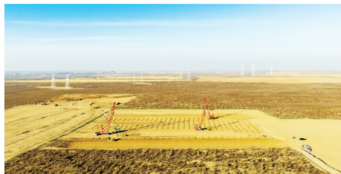
蒙西—京津冀±800千伏特高压直流输电工程开工建设。徐佳琪/摄
