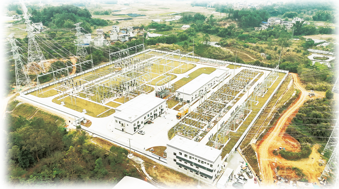
220千伏荔浦变电站建成投运,为地方高质量发展注入新动能。江政兴/摄
