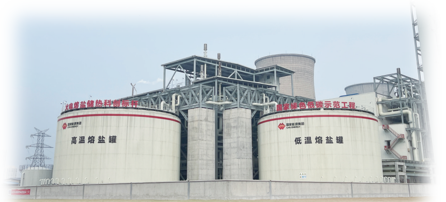
国内储能容量最大的“熔盐储能+煤电”350兆瓦机组示范项目。
