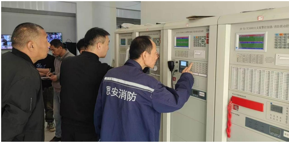
山东思安消防检测有限公司在菏泽市定陶区陶邑名都A区进行消防安全设备检测。
