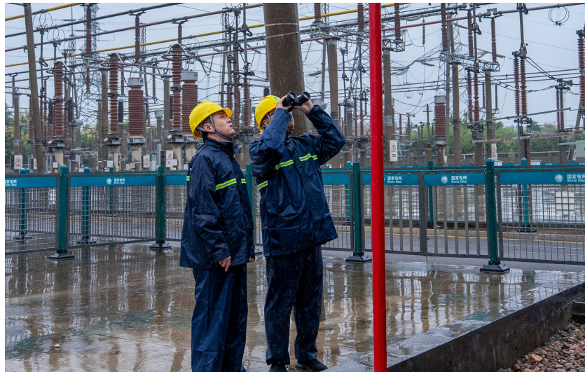
国网青岛供电公司工作人员雨天巡视变电站设备,认真排查特殊天气下电网设备安全隐患。 杨文昌摄
