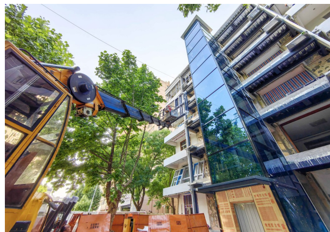
5月20日,河南省洛阳市涧西区周山路街道南峰园小区内,工人正在进行电梯加装施工。 人民视觉
