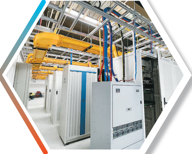
▲汕头区域性国际通信业务出入口局。 汕头华侨试验区供图
