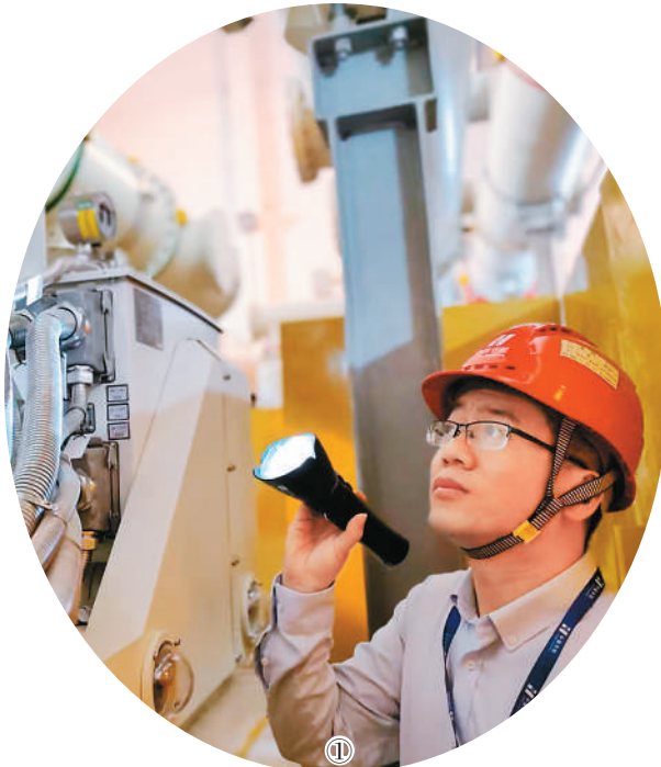
图①：华能海南昌江核电有限公司维修部工作人员在进行高压电气设备巡检。
