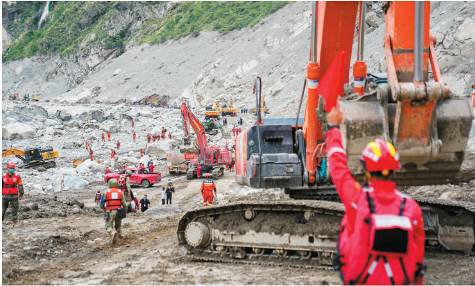
图为九月二日拍摄的吉隆泥石流灾害核心区搜救现场。新华社记者 丁增尼达摄
