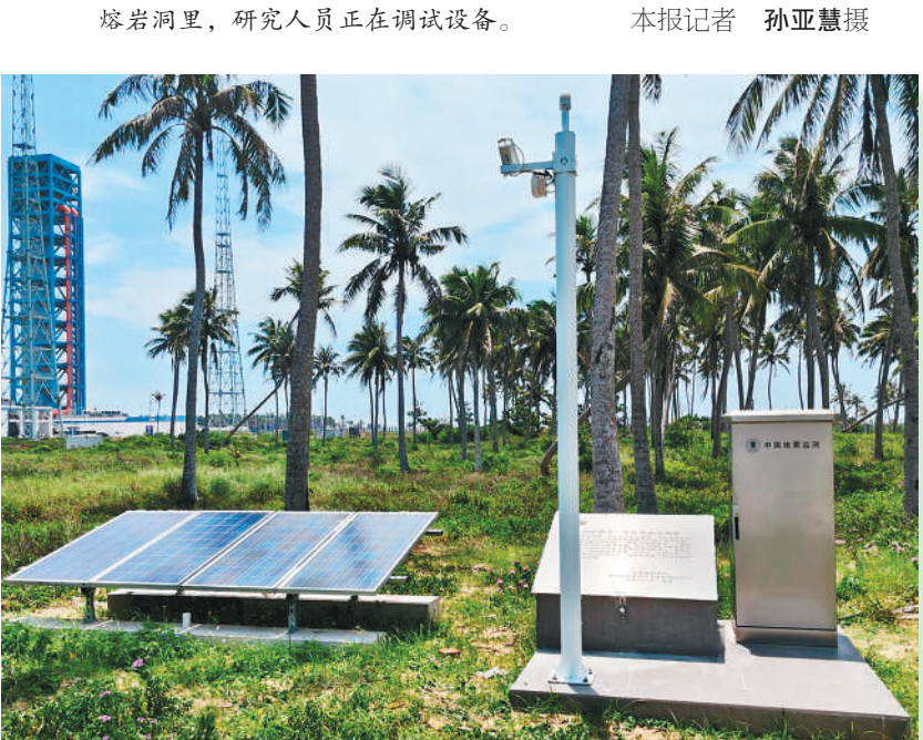
我国首座航天发射场专用地震预警监测站“海南商发一体化地震监测站”。 海南省地震局供图
