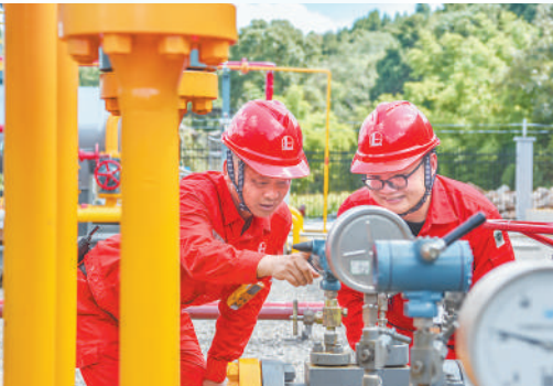
在位于四川的中江气田,中国石化西南石油局技术人员调试监测设备。宋军摄(人民视觉)
