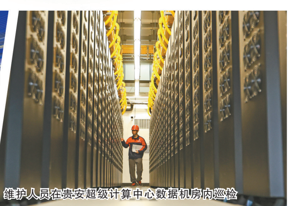
维护人员在贵安超级计算中心数据机房内巡检
