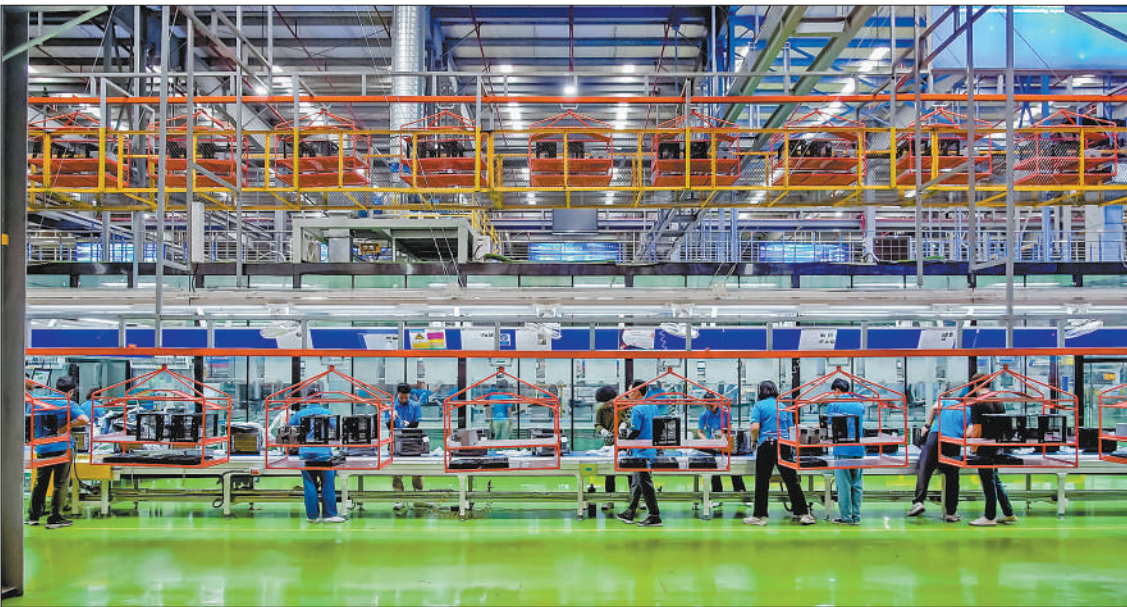
美的家用空调泰国工厂空中物流系统。
