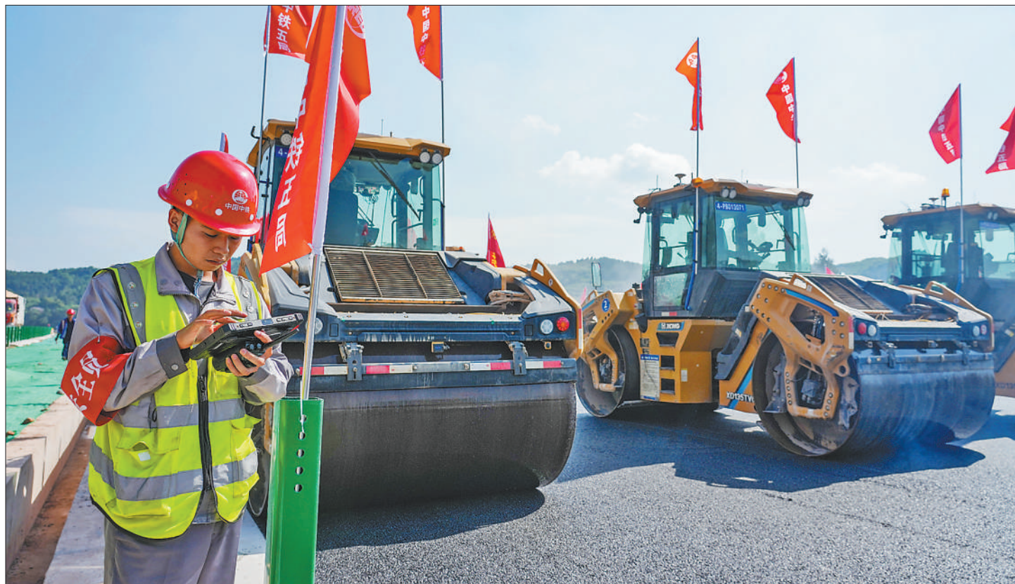
4月18日，在四川省绵阳市境内的G5京昆高速广元至绵阳段扩容工程路面工程施工现场，安全员通过道路无人化系统查看无人压路机作业状态。施工方采用无人化智能摊铺机自主作业、无人碾压集群协同推进等技术手段，进一步提升施工效率。新华社记者王曦摄
