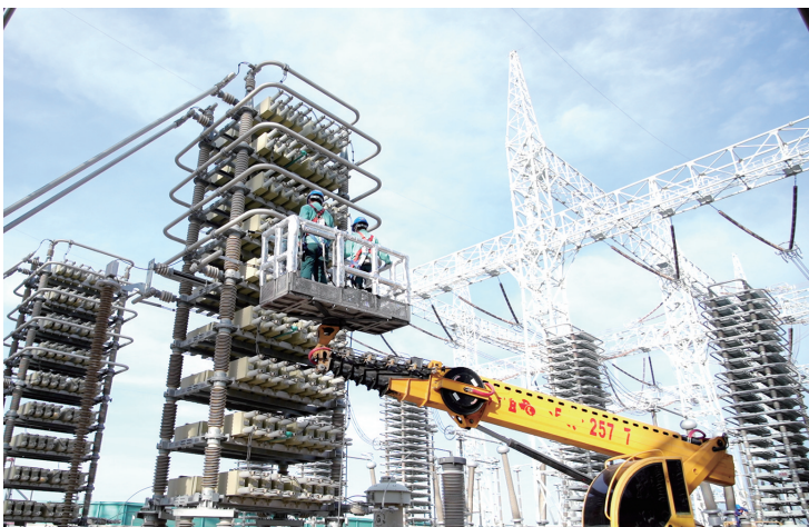
图为国网陕西电力工作人员开展陕武直流年检。
