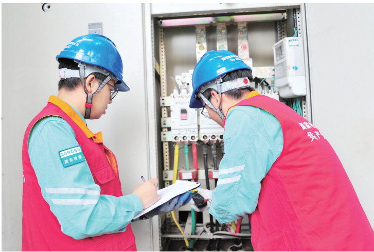
图为国网陕西电力工作人员对电力设备进行巡视检查。
